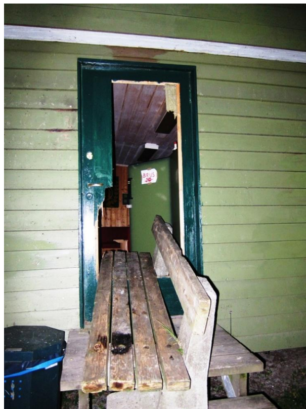
Døren smadret med betong-benk.
