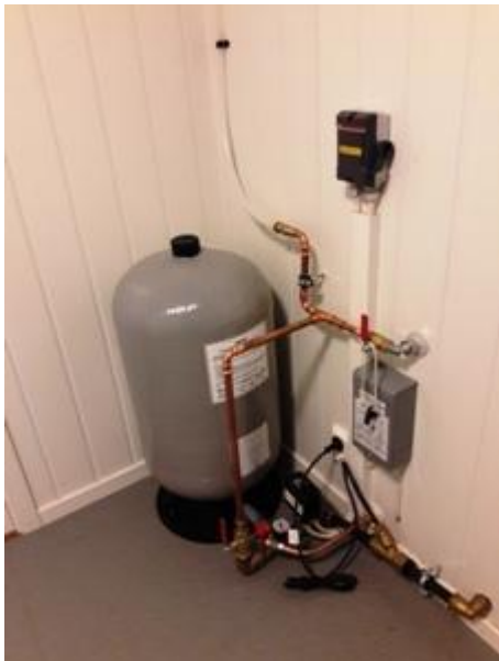
Trykk-tank med kontrollutstyr
