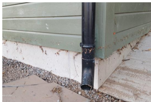
Vannstand ute helt opp på trepanelet
